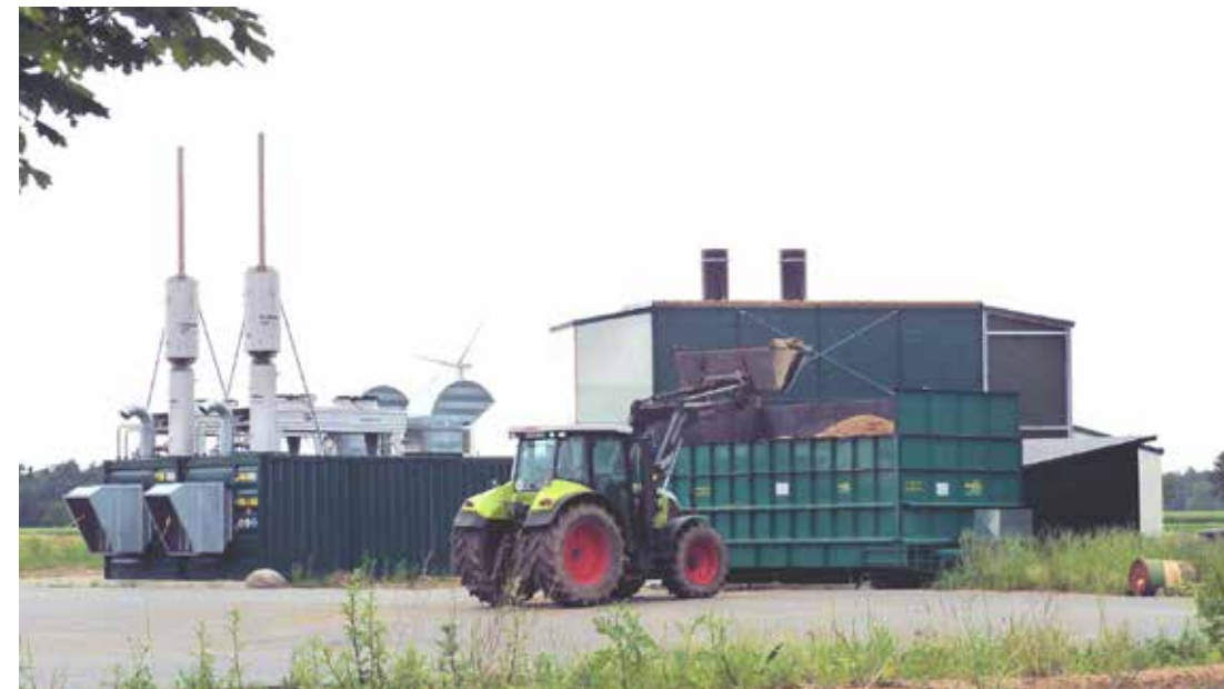
Die Biogasanlagen müssen kontinuierlich mit dem Gärsubstrat, meist Maishäcksel, gefüttert werden.
